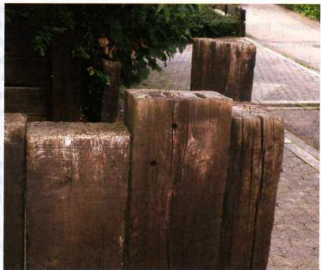
Im Garten- und Landschaftsbau werden ausgediente Bahnschwellen trotz ihrer hohen Schadstoffbelastung wegen ihrer Haltbarkeit gerne eingesetzt.
