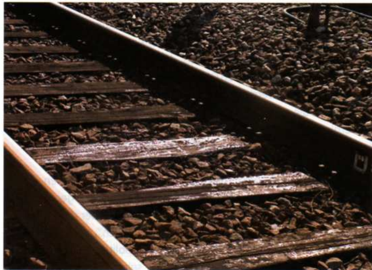
Bahnschwellen aus Holz werden allmählich durch Beton ersetzt; deutlich sind die Ausschwitzungen von umweltgefährdendem Teeröl zu erkennen.
