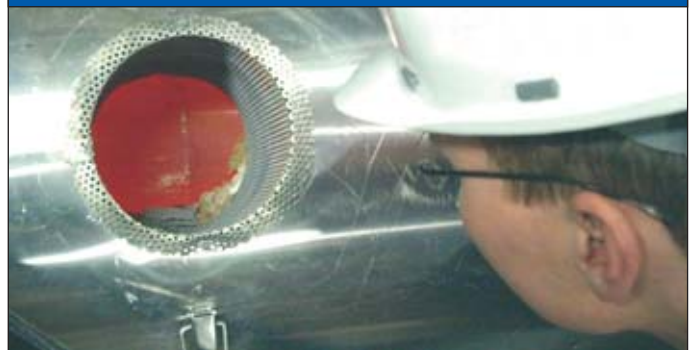
Abb 3: Rotglühende Frischdampfleitung der Komponententestanlage im Kraftwerk Scholven
