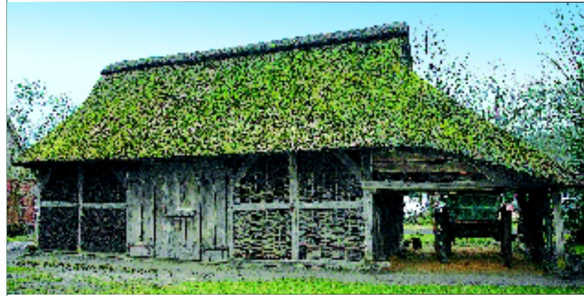
In vielen Heimatmuseen in Norddeutschland sind Reetdächer zu finden. Im Bild ein Beispiel aus Bad Zwischenahn. Fotos: Müller
